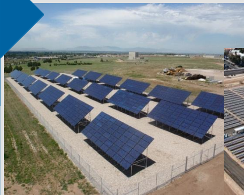
210 kW, Hill AFB, Utah
