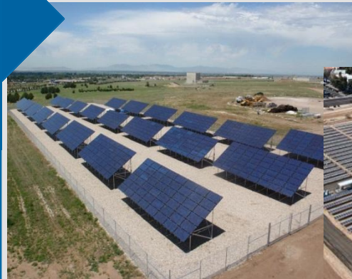
210 kW, Hill AFB, Utah
