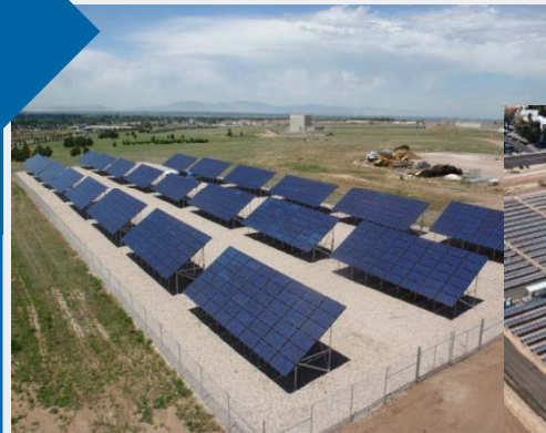
210 kW, Hill AFB, Utah
